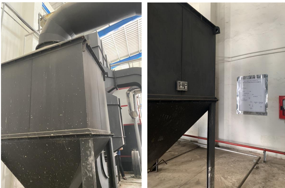
Hình 15: Hệ thống xử lý khí thải lò dầu tải nhiệt và bảng niêm yết quy trình xử lý
